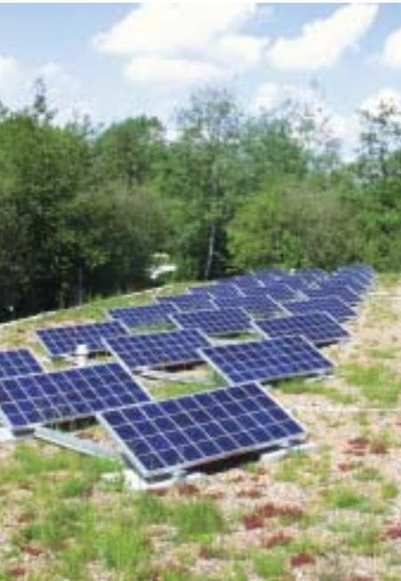
Photovoltaikanlage, Campingplatz Klausenhorn
